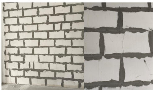
Рисунок 2 – Трещины несущих межквартирных стен
