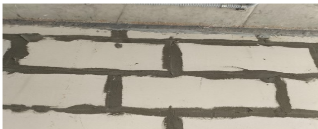
Рисунок 4 – Увеличенный зазор в месте примыкания стены к плите перекрытия с обработкой герметиком
